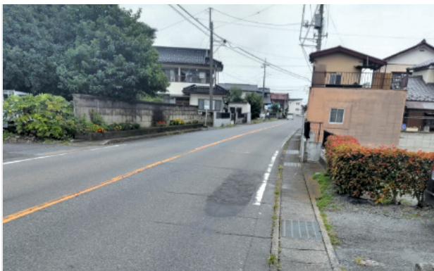
経年劣化による振動に対策を（町道の補修箇所）
