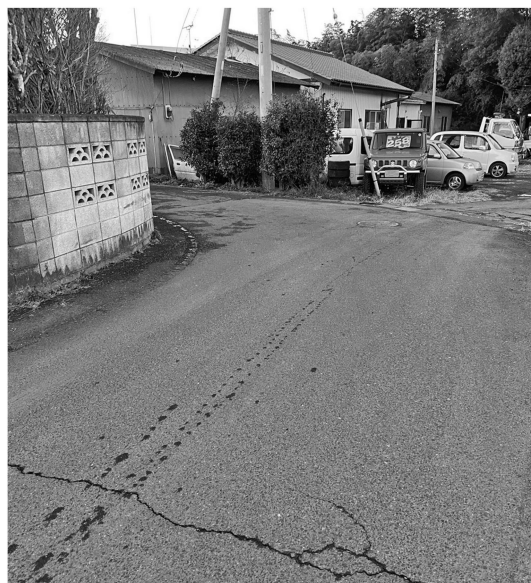
狭くて危険（役場南の町道）
