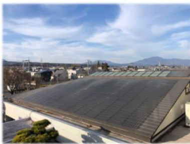
【町役場庁舎の太陽光発電設備】
